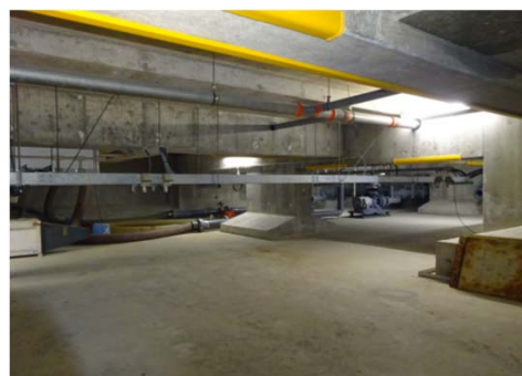
ポンプ・循環用配管等が設置された地下フロア
